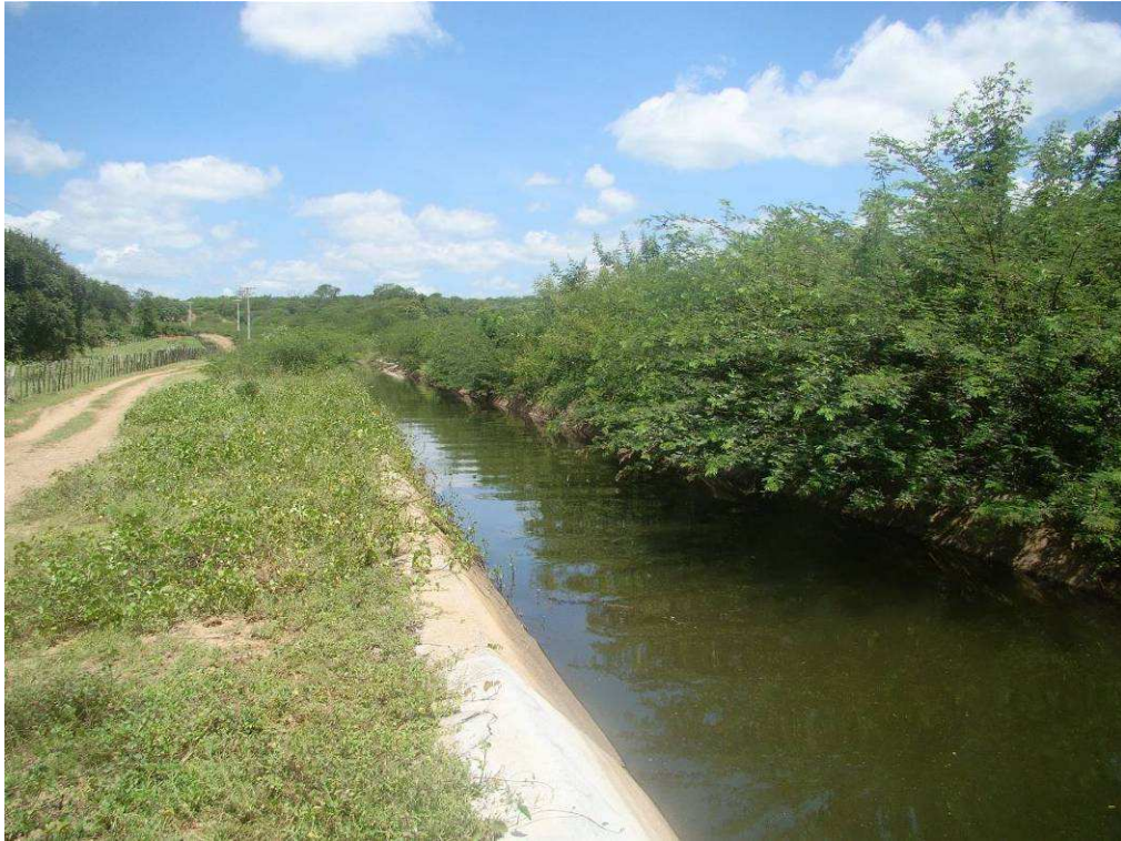
Excesso de vegetação no canal
