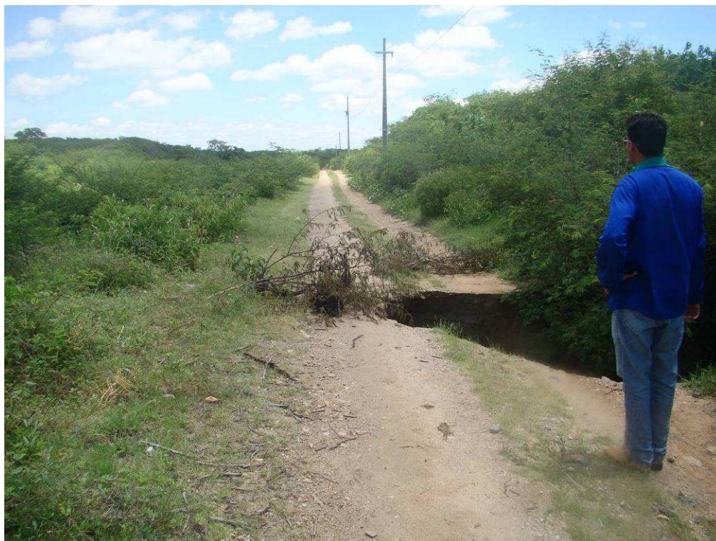
Formação de crateras na estrada ao longo do canal
