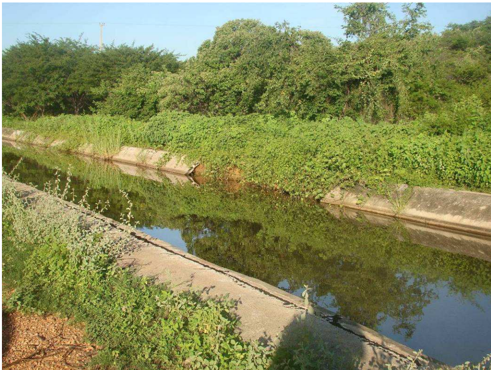
Placas de concreto destruídas
