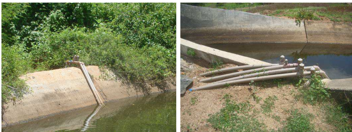
Registros dos sifões instalados e cadastrados pela AESA
